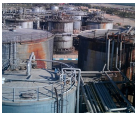
شکل ۱ مخازن ذخیره‌سازی قطران زغال‌سنگ در پالایشگاه Fig. 1 Coal tar storage tanks at the refinery
