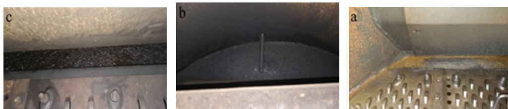
شکل ۵ تجمع حجم زیادی از رسوبات در ناودانی
