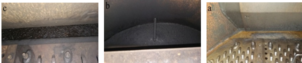
شکل ۵ تجمع حجم زیادی از رسوبات در ناودانی Fig. 5 Accumulation of large volumes of sediments in downcomer
