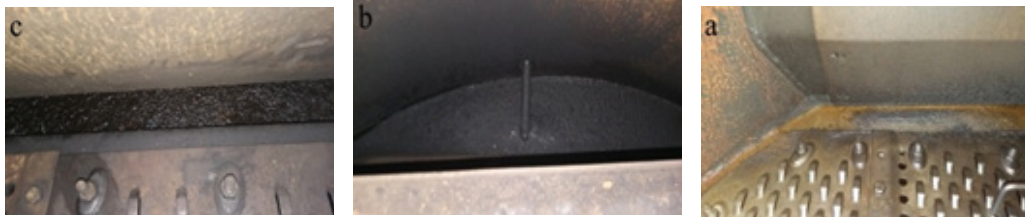
شکل ۵ تجمع حجم زیادی از رسوبات در ناودانی
